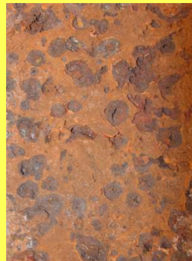
Pitting med høyt saltinnhold
